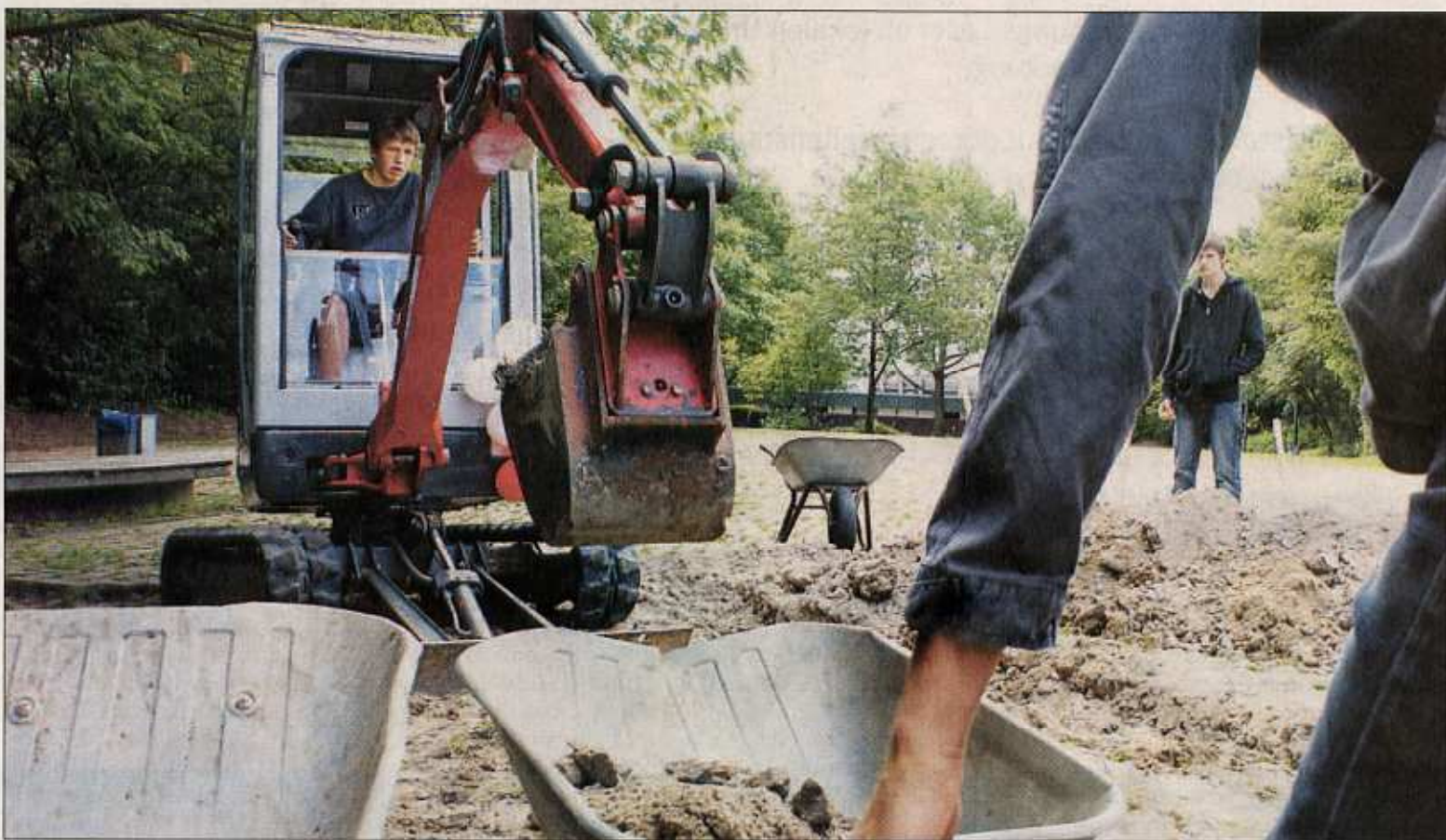
Baggerfahren wie die Bauarbeiter: Am vergangenen Samstag durften die Schüler des GSG offiziell losbuddeln.
